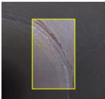
管道破损识别
